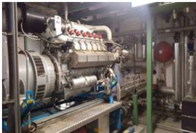
Рис 2. Биогенератор производит 350 кВт в час электроэнергию
